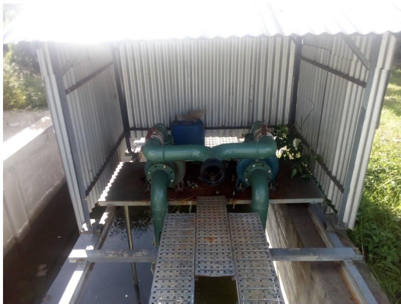
Photo 16 : Pompe P3 et P33
